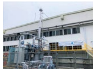
水素ボイラー
