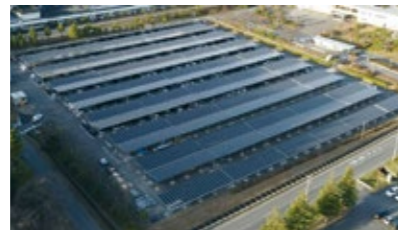
太陽光発電設備
