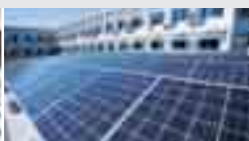
「屋上に設置された太陽光パネル」
