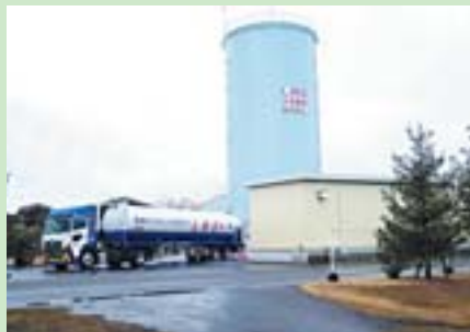
宮崎工場のLNGサテライト基地
