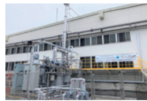
白河工場に設置している水素ボイラー
