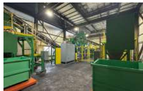
タイヤ破砕機(宮崎工場)
